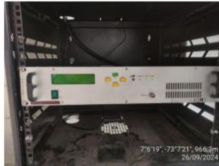
Figura-7 Instalación TX - Radioenlace MW
