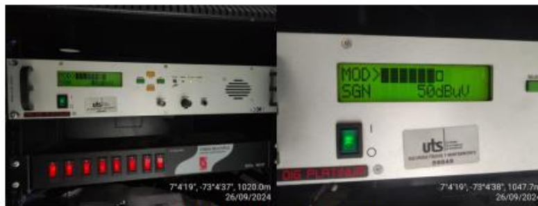
Figura-9 Instalación RX - Radioenlace MW
