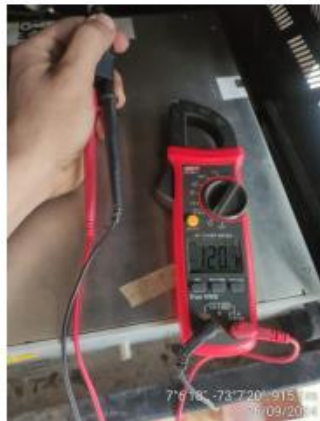
Figura-6 Medición Voltaje AC – Radioenlace MW
