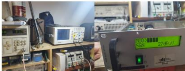
Figura-1 Pruebas Iniciales – Radioenlace MW
